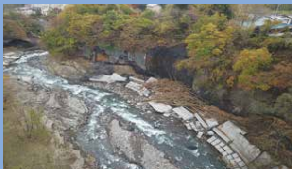
■孀恋橋上流、右岸側の護岸箇所が崩壊 撮影:令和元年11月3日
