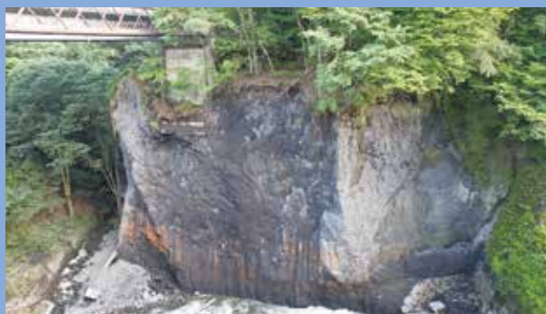
■孀恋橋直下の右岸側が洗堀される危険な状態に 撮影:令和4年8月11日
