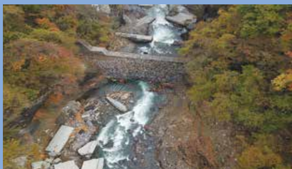
■孀恋橋上流、左岸側の護岸箇所が崩壊 撮影:令和元年11月3日
