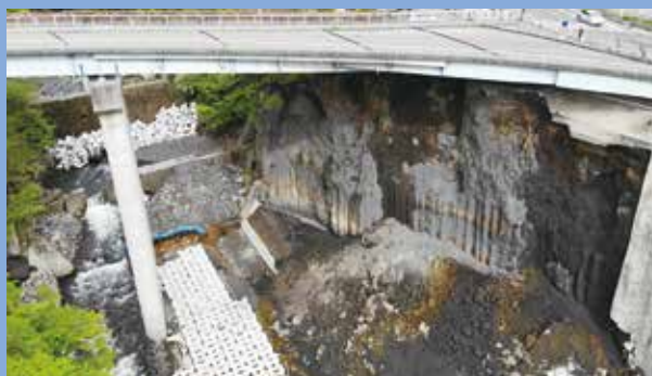
■左岸側が令和4年4月下旬に崩落し、5月10日から8月23日まで全面通行止め 撮影:令和4年5月15日
