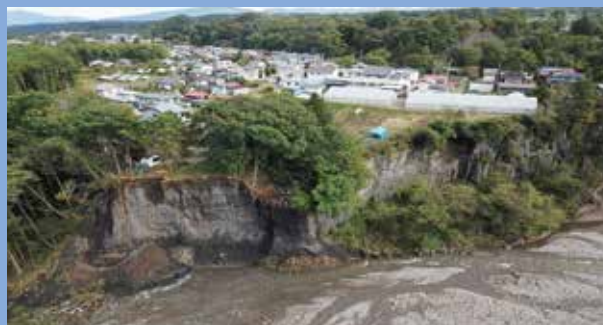
■大笹芝原地区の崖が洗掘され崩壊、建物1棟が落下 撮影:令和元年10月15日
