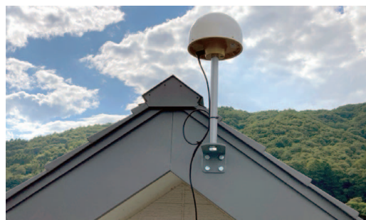
RTKアンテナ(第4分団詰所屋根)
